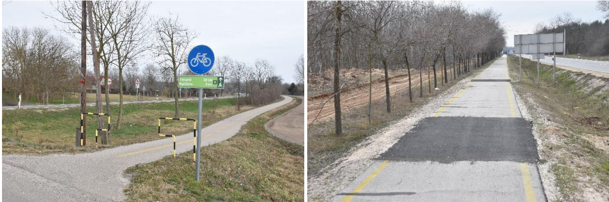
52. ábra: Kerékpárút a 44. sz. főút mentén Nyárlőrincnél / Gyökérfelnyomódásokkal sújtott szakasz
